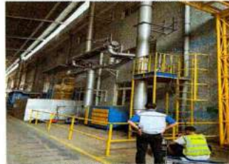
2#排气筒处理后排放口
