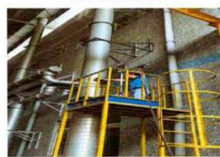
2#排气筒处理后排放口(锅炉)
