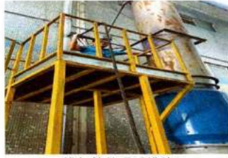
1#排气筒处理后排放口
