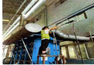
1#排气筒处理前
